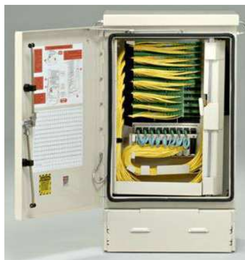
Рисунок 96: Шкаф с прединсталлированными оптическими кабелями
