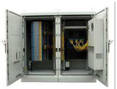
Рисунок 91: Шкаф наружной установки с системой климат-контроля
