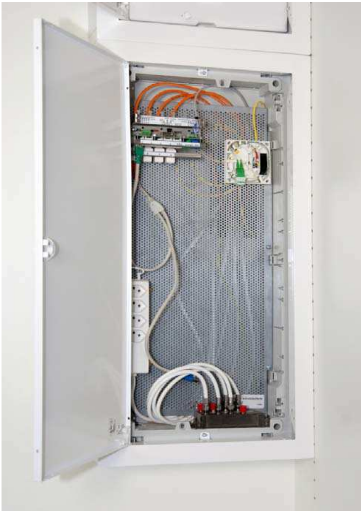
Рисунок 45: Модуль ОТО, установленный в распределительный щит абонента
