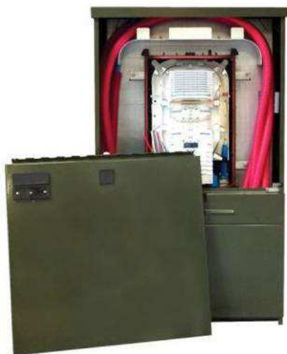
Рисунок 95: Типичный вид шкафа наружной установки
